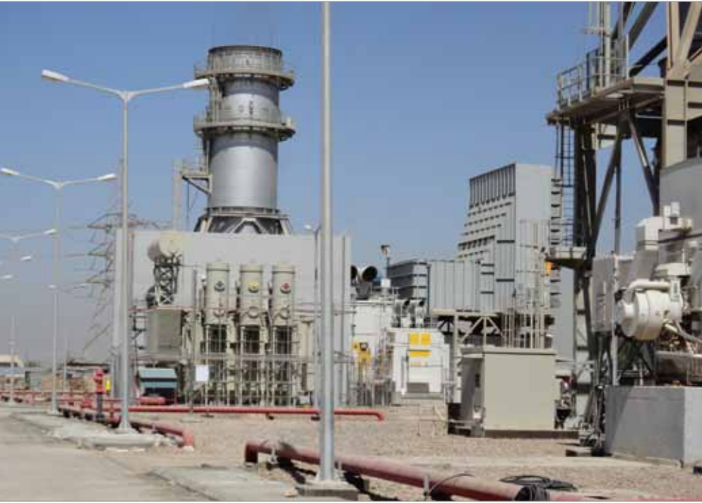
محطة كهرباء القدس الغازية في محافظة بغداد
